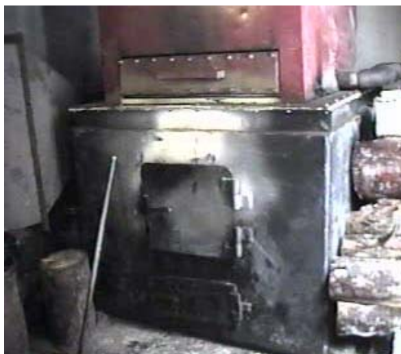
Рис.2. Котел KV-0,5, работающий на дровах, котельная Лесотехникума, г. Ветлуга, Нижегородская область
