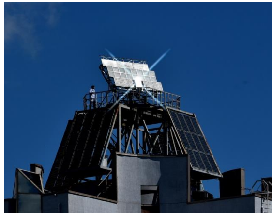
Концентраторная энергоустановка (2кВт) на крыше СПб Академического университета
