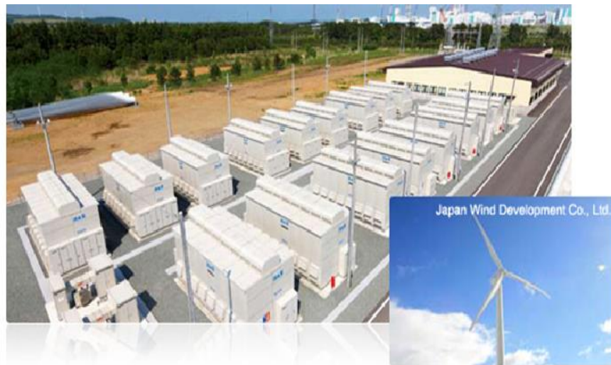
Применение серно-натриевых аккумуляторов для регулирования работы ветроэлектростанции мощностью 51 МВт (вверху, мощность накопителя 34 МВт). Tomamae Wind Farm.
