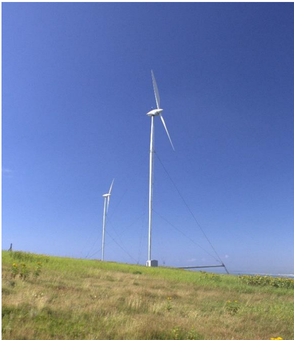
Мощность ВЭС- 550 кВт
